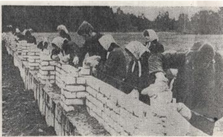
Kieģelis pie ķieģeļa tiek likts ar ceofnu. Jaunā pēnu kūēs Lēdmanes kolhozā — tā da- daiem studentu celtnieku vienības «Daugava» biedriem ir pirmā skola būvdarbos. P. Zosina foto
